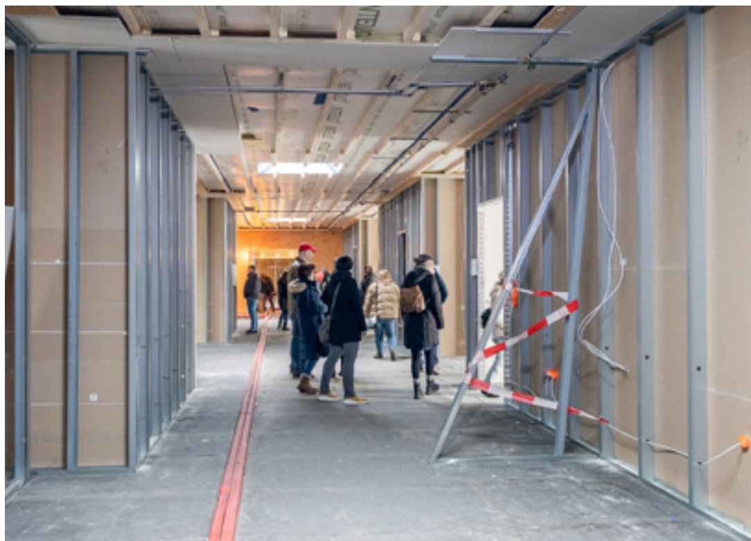
Im Neubau der KiTa „Wachtelnest“ werden nach Abschluss der Installationsarbeiten derzeit die Trockenbauwände beplankt, damit demnächst der Estrich eingebracht werden kann. (Foto: Marc Braner)
