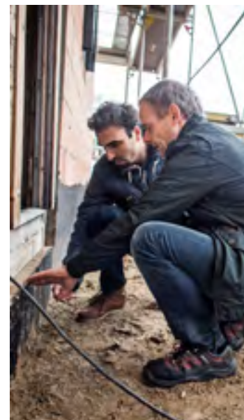
Typische Fehler am Neubau, welche die Energieeffizienz beeinträchtigen können: Bauteilanschlüsse, die Wärmebrücken entstehen lassen.
