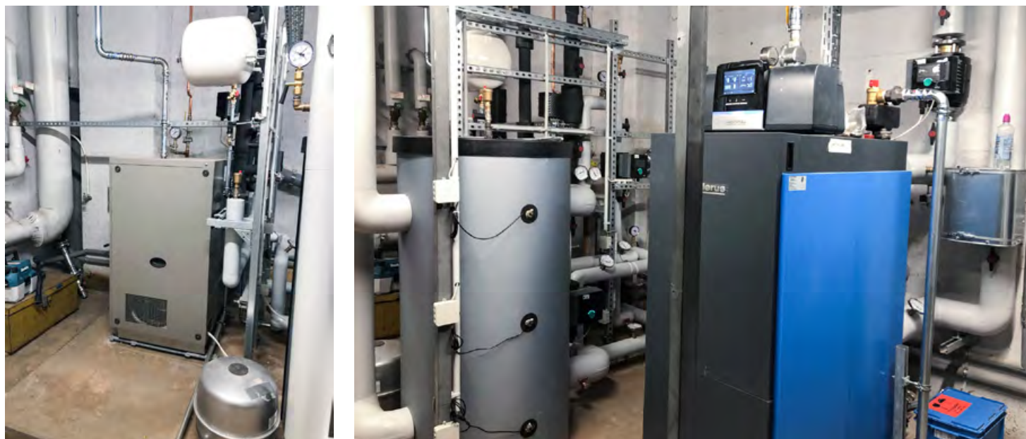
Erdwärme-Tauscher (l.) und Gas-Brennwert-Heizung sorgen zukünftig für eine emissionsarme Wärmeversorgung in der Grundschule Monsheim.
